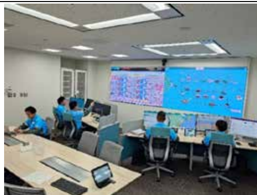
上工下水運転状況の遠隔監視の様子（SPC 本社）
